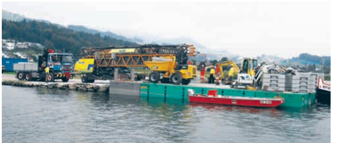
Ein Lastwagen schiebt den Kran auf den Ponton. Entladen wird er später mithilfe des Dumpers, der die Überfahrt ebenfalls mitmacht.
