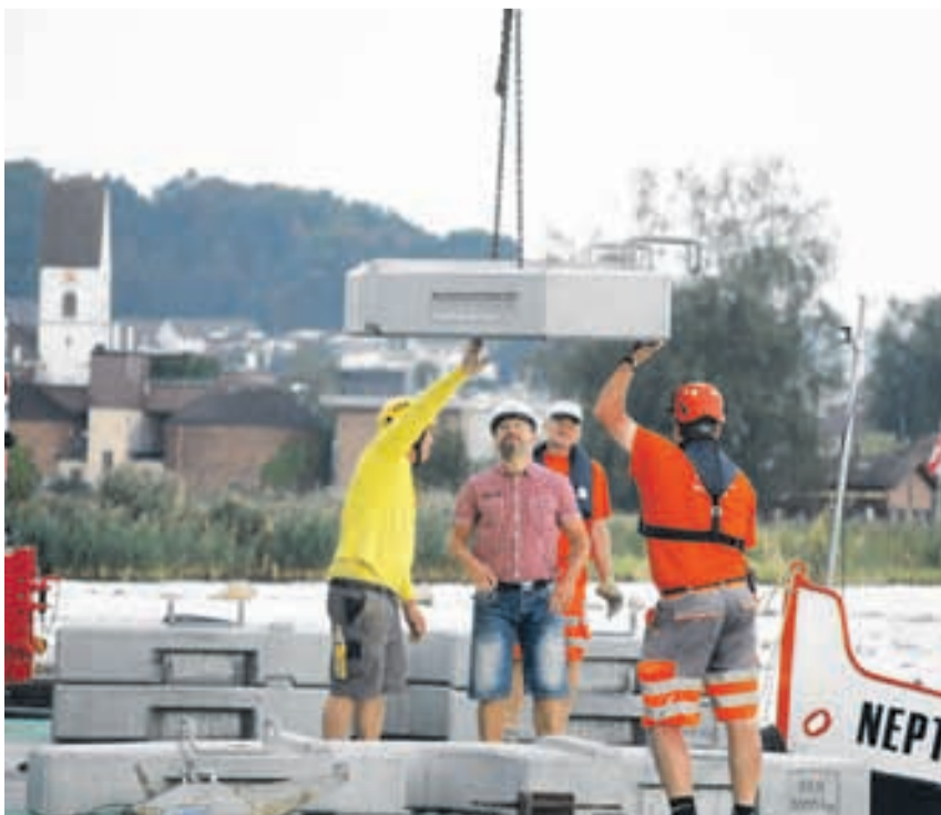
Zwei Tonnen schwere Betonklötze, normalerweise als Gegenballast für den Kran verwendet, dienen dazu, den Ponton auszugleichen.
